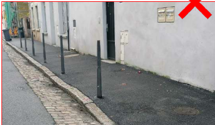
Trottoir non accessible pour les personnes à mobilité réduite, 13 rue du Capitaine, Lyon 3e
