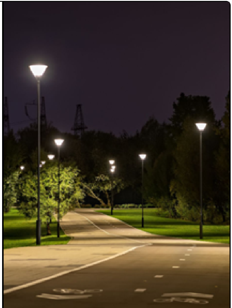
ÉCLAIRAGE INTELLIGENT D'UNE PISTE CYCLABLE MALIGNES
