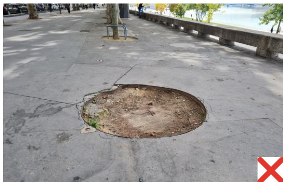
Pied d'arbre non rebouché qui risque de provoquer des chutes
