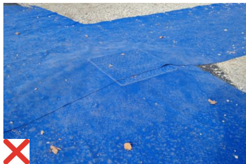
La chambre mise à la côte n'est pas bien visible sous le tapis de chantier. Elle risque de provoquer des chutes.
