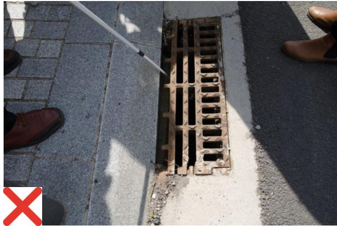
Exemple de grille de recueil des eaux pluviales qui ne respecte pas la réglementation
