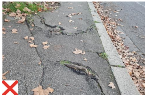
Racines sortantes qui risquent de provoquer des chutes
