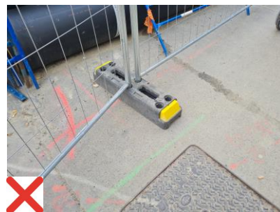
Piètement de barrière qui dépasse sur le cheminement
