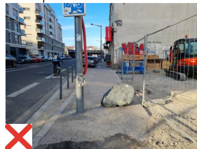
Obstacle non déplacé dans le cadre des travaux qui gêne le cheminement
